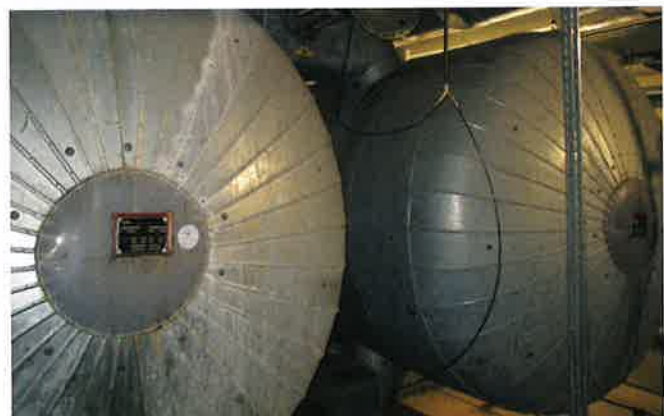
Die neue GEA-Kälteanlage setzt auf das natürliche Kältemittel Ammoniak. Im Bild: Die großen Ammoniak-Behälter
