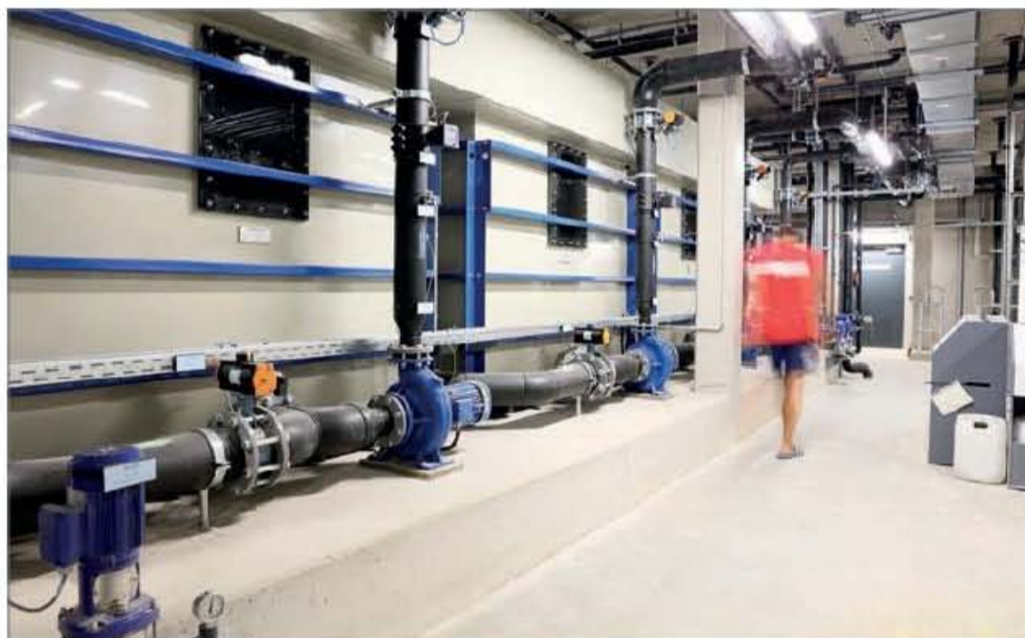
■ Ein großzügiger und „aufgeräumter“ Technikkeller
