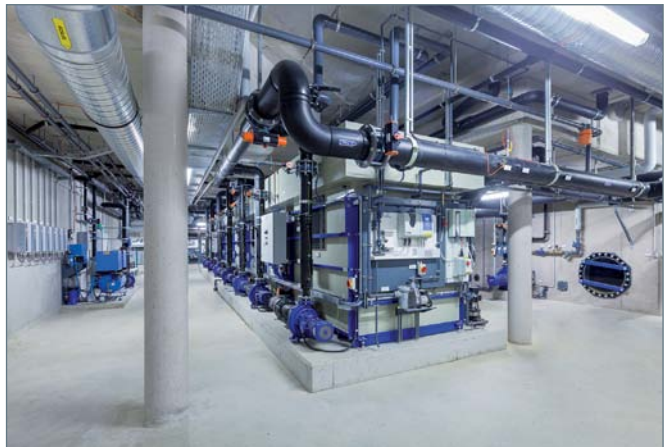
■ Filteranlage; Fotos: Christiane von Reinersdorf, Hamburg
