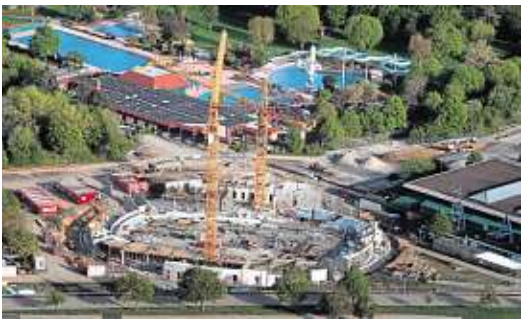
Die Halle (Mai 2012) hat einen Durchmesser von 85 Meter und ist 16,50 Meter hoch. Archivfoto: Drossel
