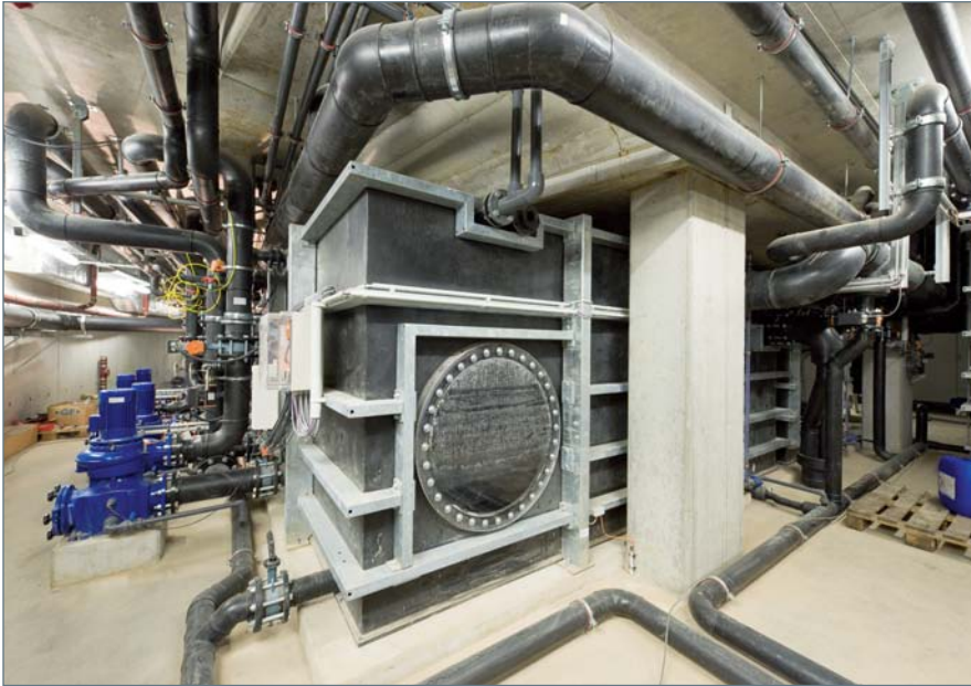
■ Niederdruckfilteranlage der Badewasseraufbereitung
